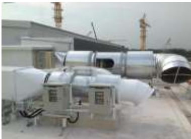
Gambar 1. Exhaust Fan Outlet pada Industri [7]
